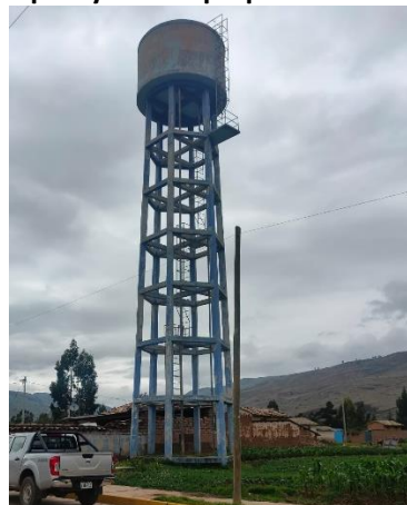
Reservorio elevado 40 m 3 Huacrapuquio
