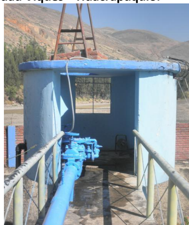
Vista frontal de caseta de equipamiento
