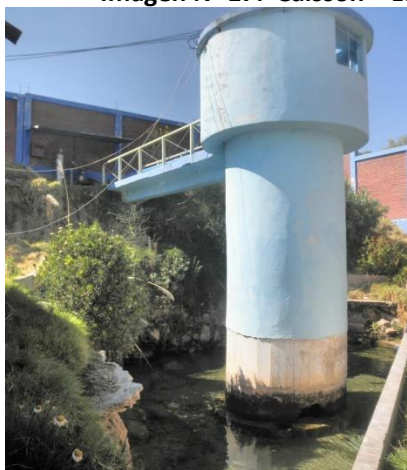
Captación tipo Caisson
