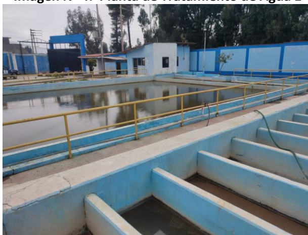
Imagen N° 4: Planta de Tratamiento de Agua 1
