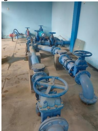
Imagen N° 12: Estación de Bombeo
