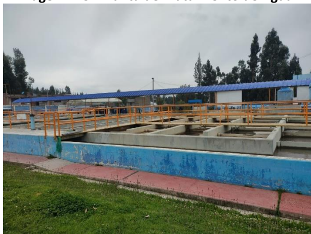
Imagen N° 5: Planta de Tratamiento de Agua 2
