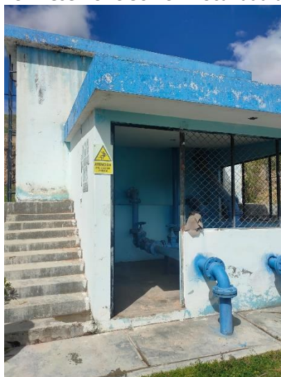
Imagen N° 13: Reservorio 50m 3 – Localidad de Orcotuna
