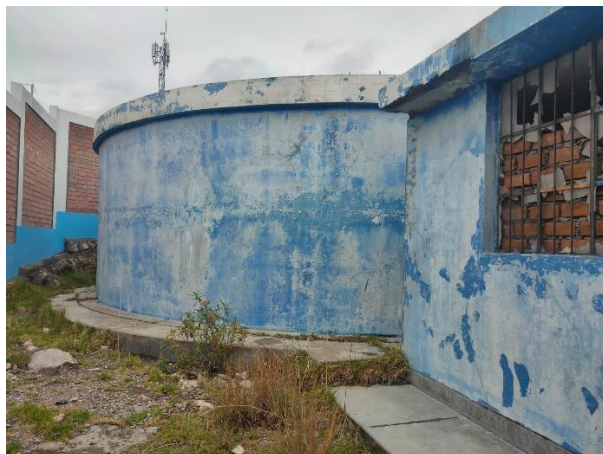
Reservorio apoyado de 200 m 3
